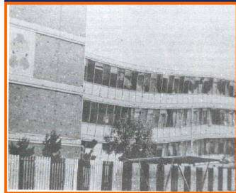
Escuela dañada, Distrito Federal
